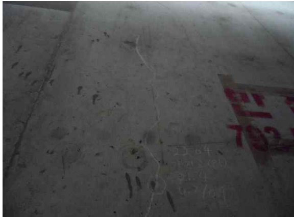
P1 코핑부 균열(폭 0.2mm)
