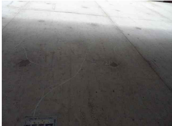
P1 코핑부 균열(폭 0.2mm)
